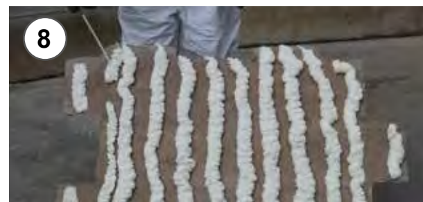
8 - Applicazione della schiuma poliuretanic distanziando le strisce di circa 10 cm 8 - Application of polyurethane foam spacing the strips of about 10 cm
