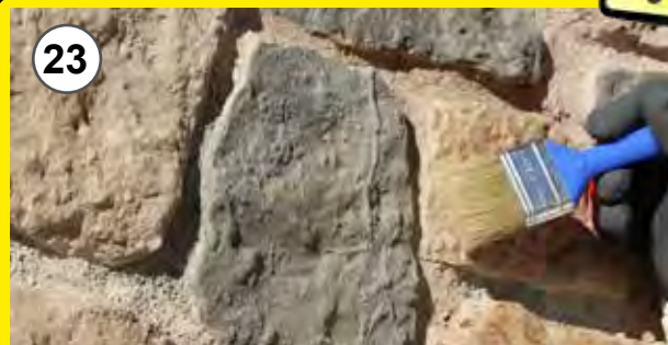
23 - Per ottenere una colorazione uniforme, oltre a colorare il giunto ricostruito, sfumare sui giunti adiacenti 23 - To obtain uniform coloring in addition to coloring the rebuided joint fade out on the adjacent joints
