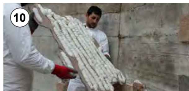
10 - Applicazione del pannello sulla parete con leggera pressione 10 - Applying of panel on the wall with light pressure
