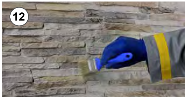
12 - Pulitura del giunto con pennello asciutto 12 - Cleanup the joint with a dry brush
