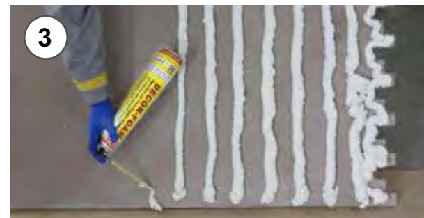
3 - Applicazione della schiuma poliuretanic distanziando le strisce di circa 10 cm 3 - Application of polyurethane foam spacing the strips of about 10 cm
